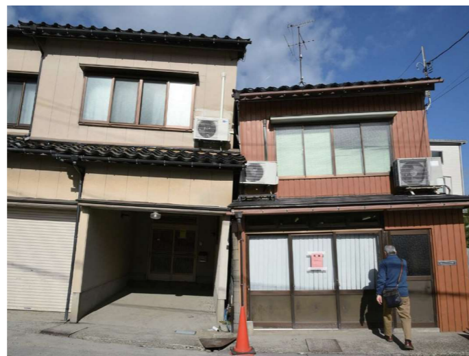
液状化被害によって傾いた建物
