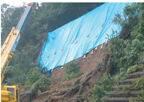
集中豪雨による土砂崩れ（伏木矢田）
