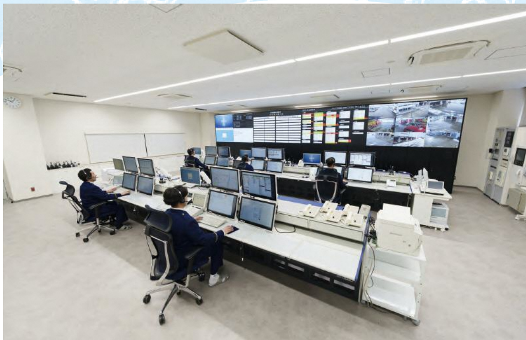
市民の安全を守る司令塔 県西部消防指令センター
