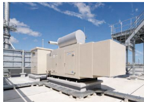
停電にも対応できるように 屋上には大きな非常用電源があります
