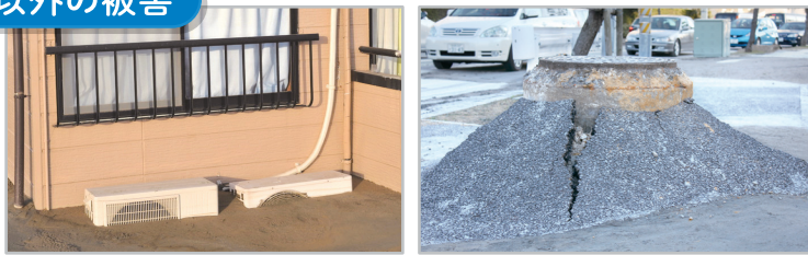
傾斜や噴砂による埋没(左)、敷地内の排水管やガス管などの破損・詰まり、マンホールの浮き上がり(右)など
