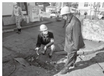
能登半島地震被災現場確認
