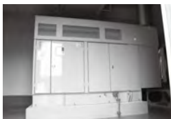
▲住吉ポンプ場の受変電及び自家発電設備
