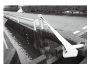
大雪によるガードレール破損
