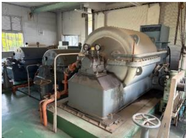
曝気ブロワ装置の改築・更新(四屋)
