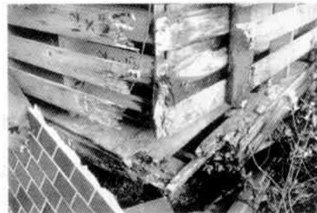
柱や土台の腐朽・蟻害
