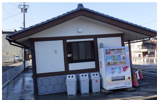
傾斜の被害状況写真（噴砂や基礎の亀裂等、何かしら沈下や傾斜の被害を受けたことが分かる写真を添付してください）
