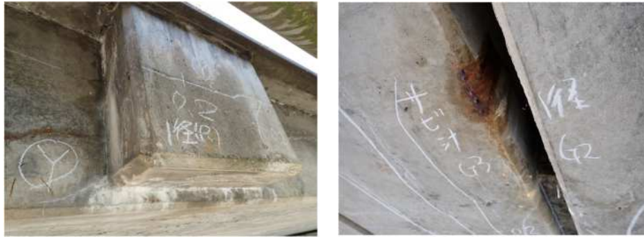
横締め定着部周辺の錆汁を伴うひびわれ 間詰め部からの錆汁の発生
