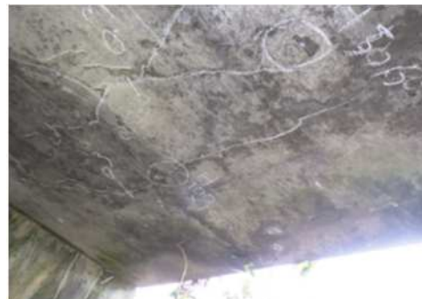
A S R が原因と推定されるひびわれ
