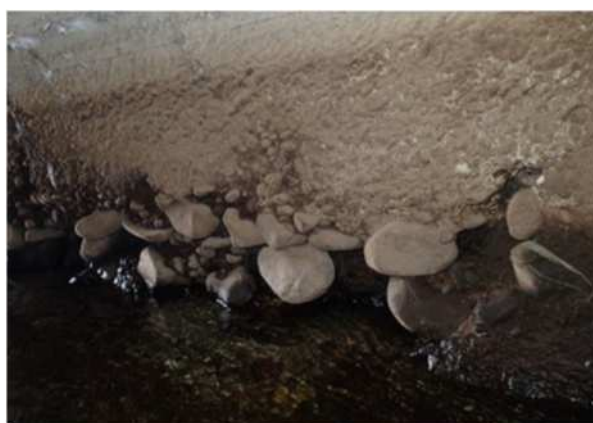
写真 8.1 粗石コンクリート橋台の変状例
