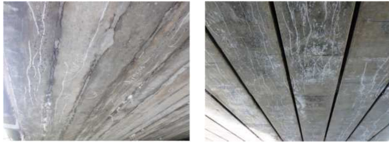
A S Rが原因と推定されるひびわれ
