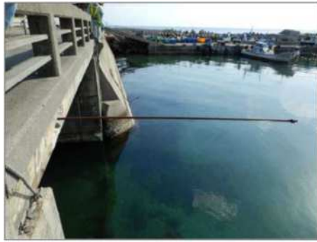
横締め鋼材の破断・突出
