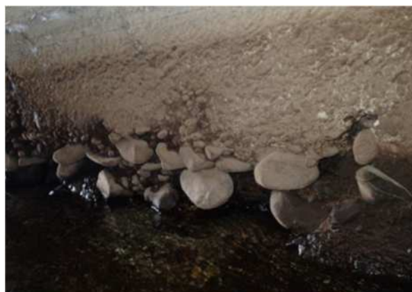
写真 8.1 粗石コンクリート橋台の変状例
