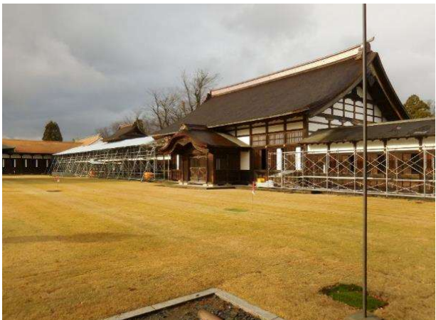
【大茶堂・高廊下】屋根工事完了 【北回廊】素屋根組立中 ①
