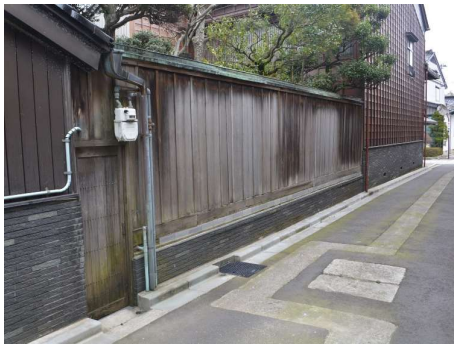
【山内家住宅主塀】修理前
