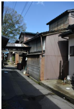
【神初家作業場】修理前
