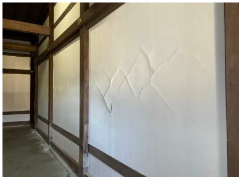
漆喰壁割れ、落下等の被害
