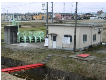
【石瀬ポンプ場】
