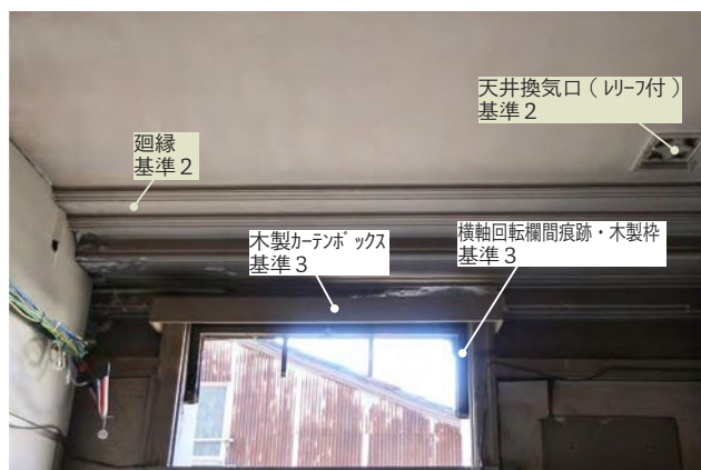
【西面】横軸回転欄間痕跡
