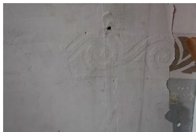
壁面塗装下のステンシル装飾痕跡（要調査）
