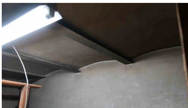
北棟金庫室 2 階の耐火天井
