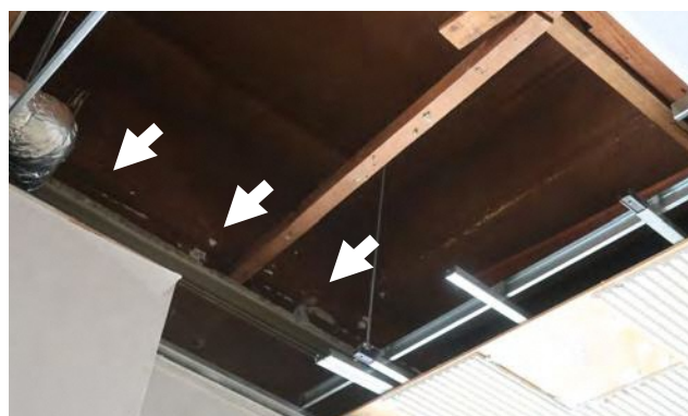
同左（矢印は中古の木製廻縁で、天井が少なくとも 2 回下げられたことがわかる）
