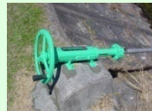
ゲート、バルブの更新
