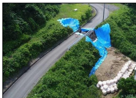
H30土砂崩れ
